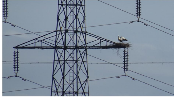
Nog een nieuw nest, nu in een hoogspanningsmast langs de vierakkersstraatweg.
